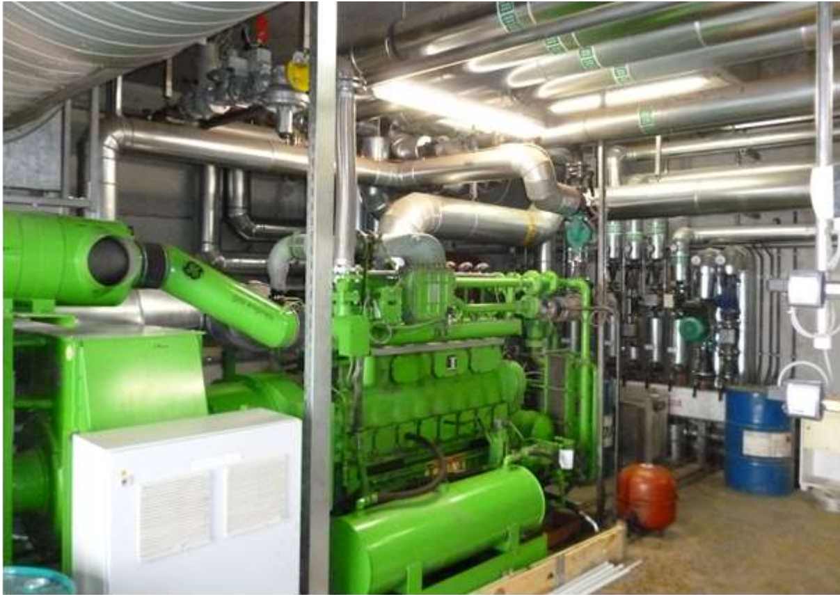
Abb. 83: BHKW der Trockenfermentationsanlage Erfurt
