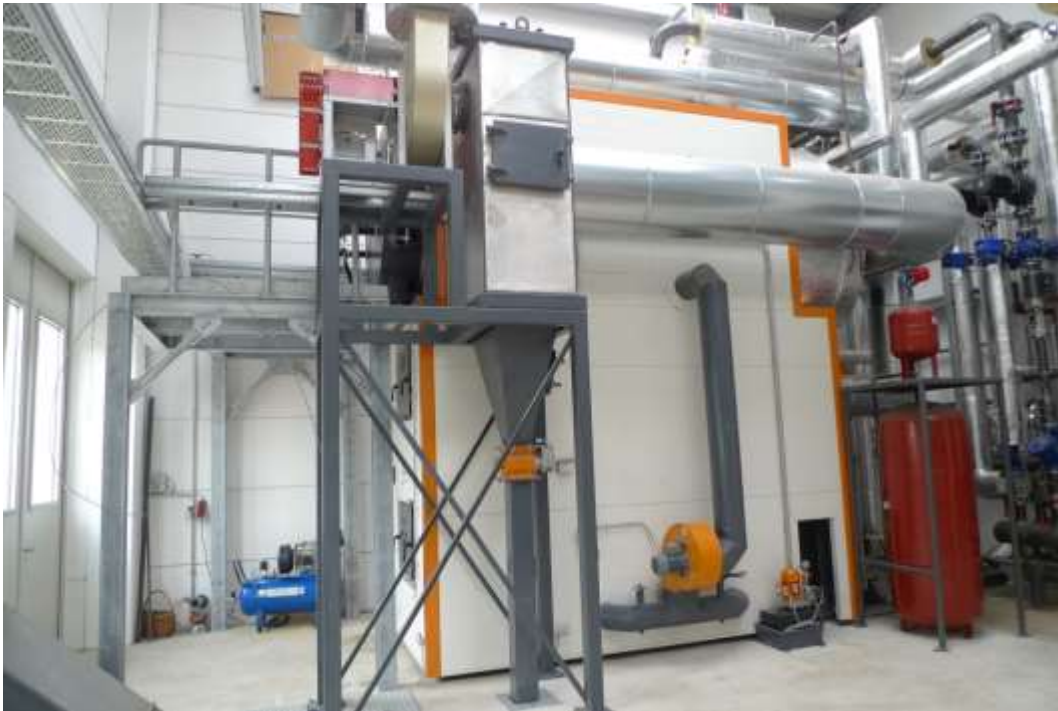
Abb. 79: Heizwerk Tanna – Innenansicht Kessel
