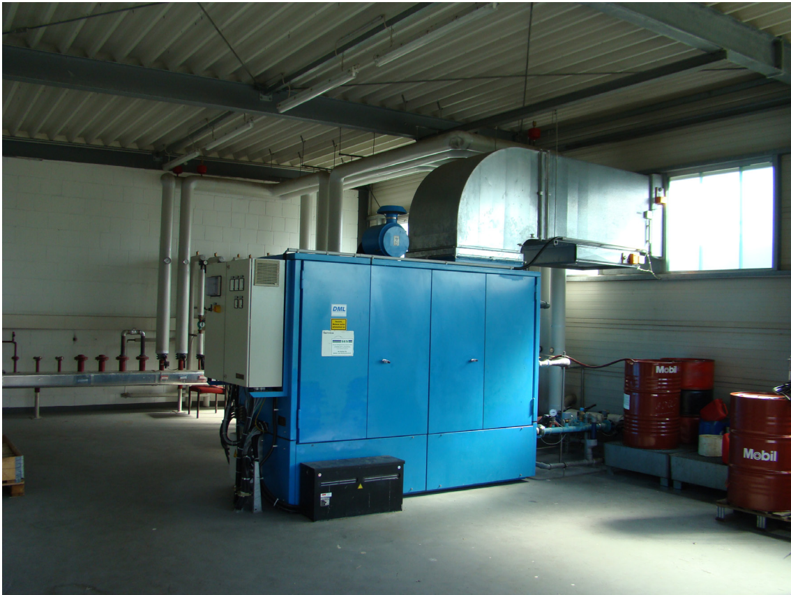
Bild 1: Blockheizkraftwerk der Kläranlage Schmalkalden Bildquelle: TLUG Jena
