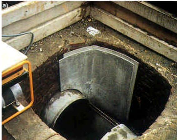
Abbildung 52: Einbringen vorgefertigter GFK-Elemente in einem Schacht
