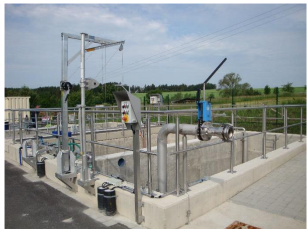
Abbildung 48: Kläranlage Tegau (Quelle: TLUBN)
