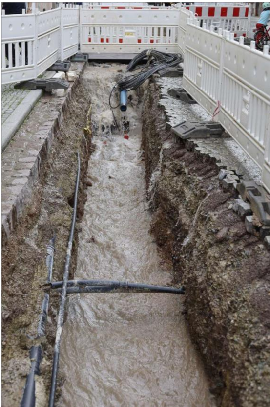
Abbildung 80: Rohrbruch in Ilmenau (Quelle: TMUEN P/Ö)
